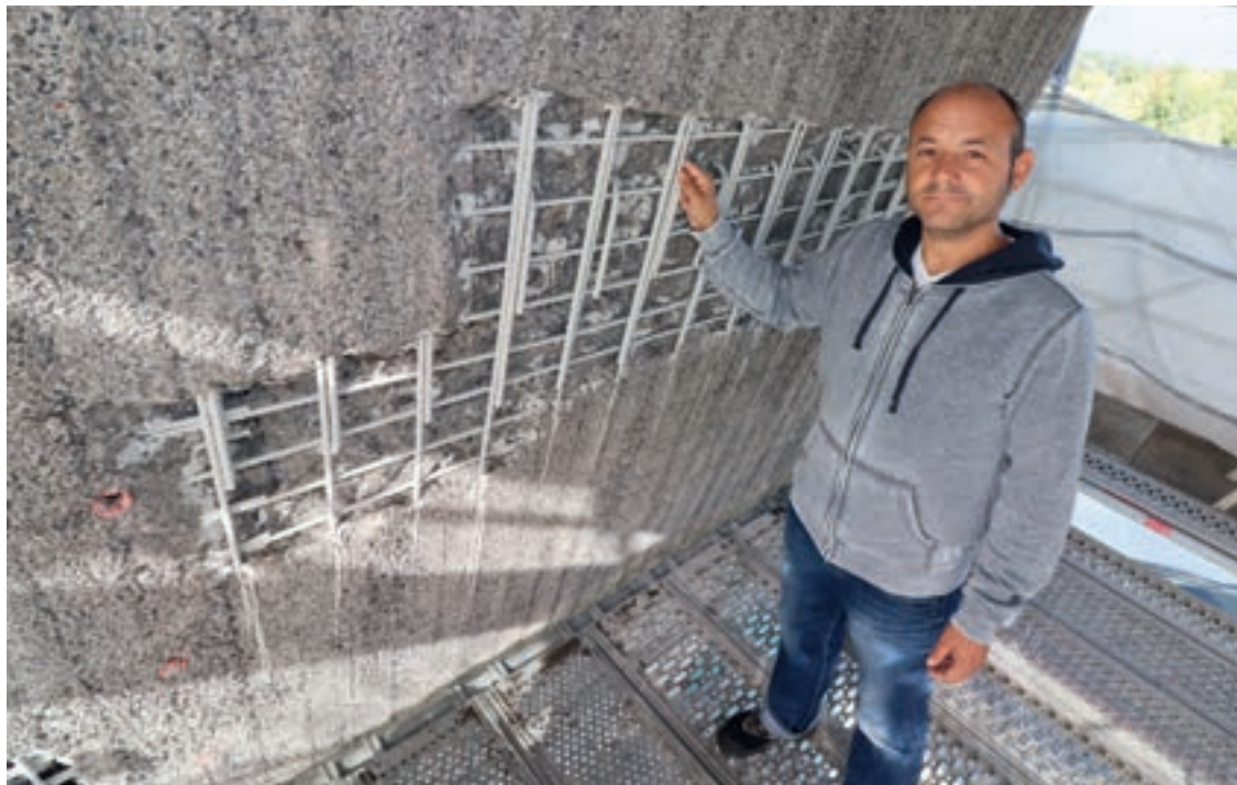
Thorsten Holtkötter, Betriebsleiter der Kläranlage Lippestadt, neben einer sanierungsbedürftigen Stelle am Faulturm.
