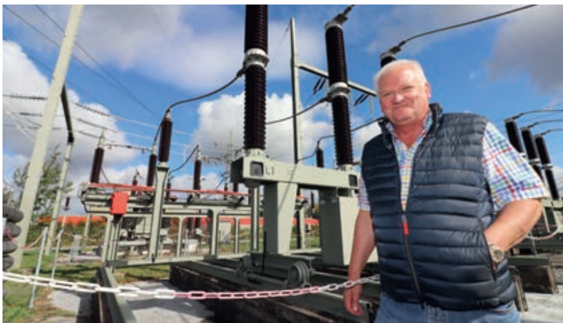
Hinter die rotweiße Absperrkette im Umspannwerk Roßfeld darf noch nicht mal Elektrospezialist Martin Kettelhake. – Lebensgefahr.
